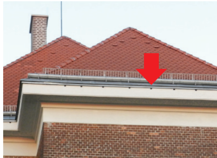
10. Bezirk, Triester Straße, MA 49: Bei Sanierung neu geschaffene Zugänge zu Hohlräumen im Vordach. Foto: M. Stocker
