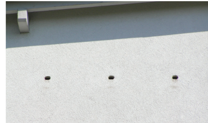
Linz, Solar-City: Mauerseglernistkästen montiert unter Putz, nur die Einflugöffnungen sind noch sichtbar Foto: M. Stocker
