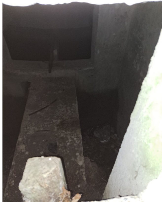
Abb.: Gefahrstelle in der Bunkeranlage Maurer Wald
