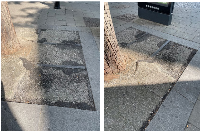
Fotos 1 & 2: Beschädigte Baumscheiben-Abdeckungen
