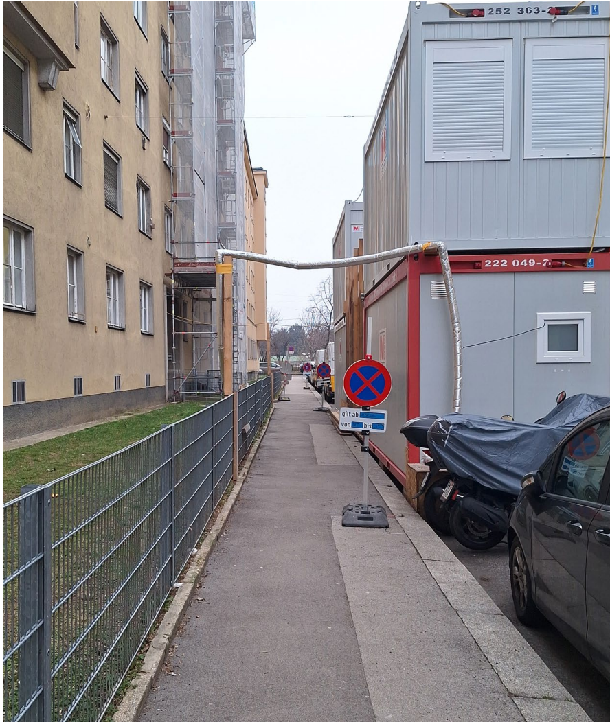
Baustelle Miesbachgasse 15 – Unnötige Einengung des Gehsteigs durch Baustellenschilder
