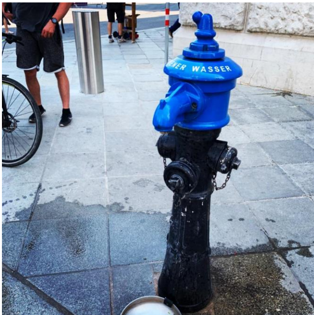
Foto Trinkbrunnen am Hydranten ( © Grüne Wien)
