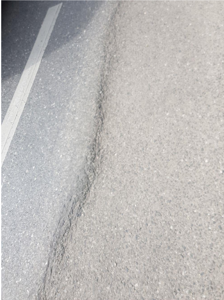
Aufwerfung des Asphalts Linzer Straße ONR 441 ca. 10 cm hoch
